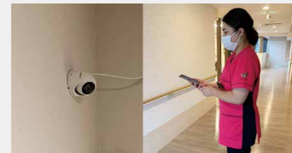
ナースコールがスマホと連携しカメラで様子を確認できる (介護老人福祉施設わかたけ南)
